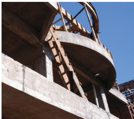
Figura 1 – Escada localizada em local de risco.
