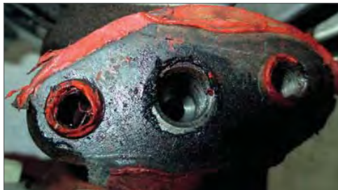
Fig. 22.1.1.8 – Obstrução da passagem de óleo lubrificante do turbo.
