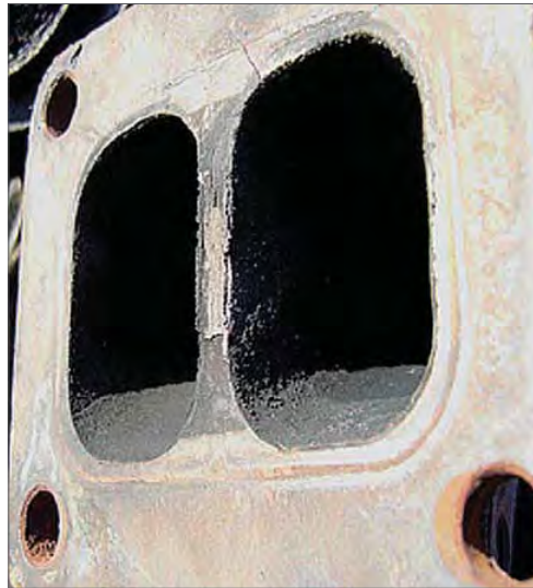
Fig. 22.3.2 – Trincas e escamação da carcaça.
