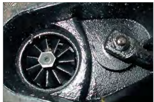
Fig. 22.4.4 – Óleo lubrificante na carcaça da turbina.
