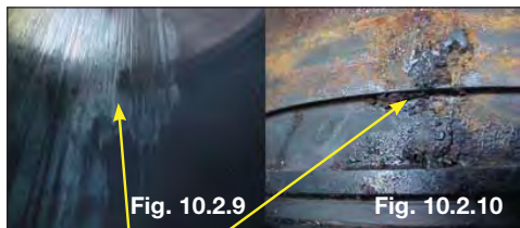
Fig. 10.2.9: Engripamento originado devido ao deslocamento do anel o'ring. Fig. 10.2.10: Impureza no alojamento do anel o'ring na camisa.
